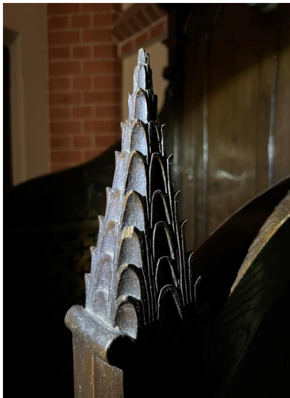
Fot.19. Drobne ubytki drewna – konfesjonał mały.
