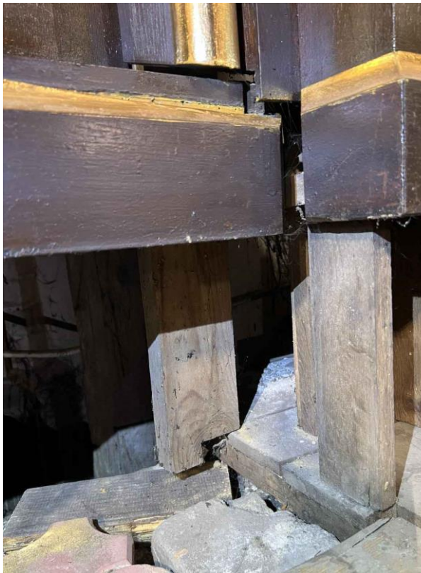
Fot.2. Dezintegracja konstrukcji – ołtarz główny.
